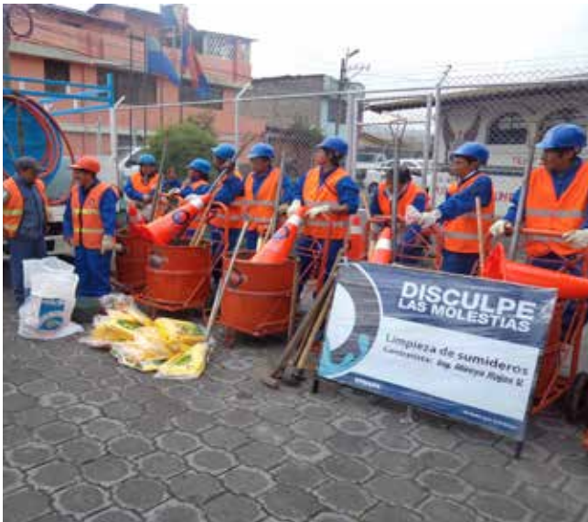
Equipo de limpieza de sumideros Sector sur de Quito
