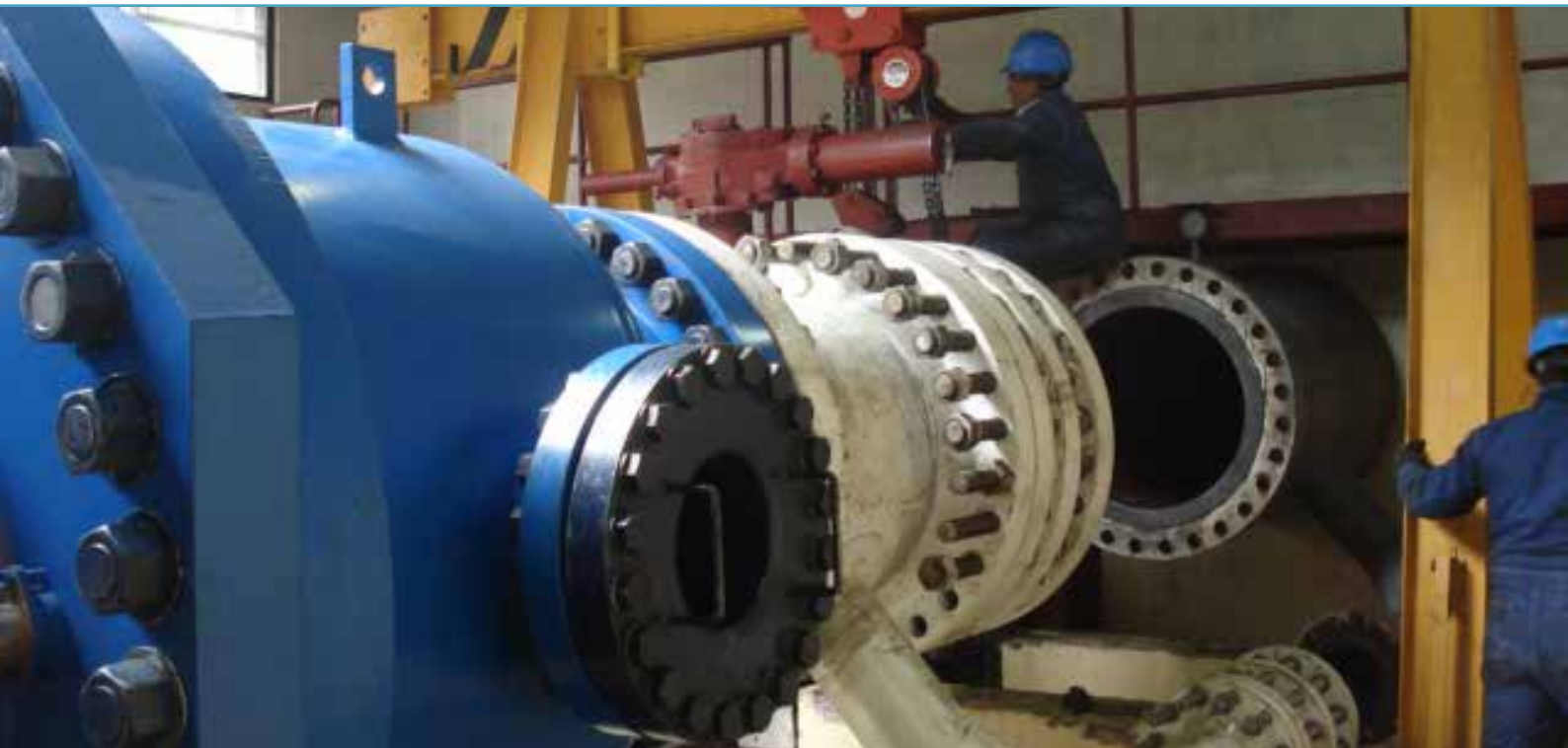
Se observa el lugar donde se instalará la válvula esférica de 30 pulgadas
