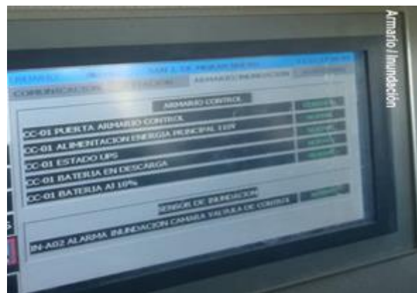
Visualización Parámetros Eléctricos
